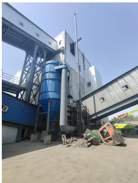
3#除尘器（含风机）排气筒（DA028）
