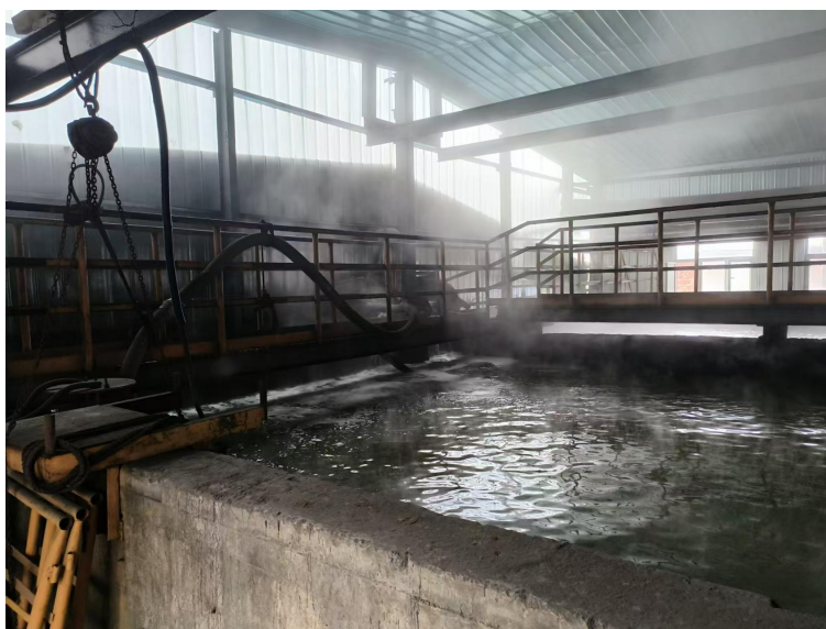
循环冷却系统循环水池
