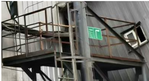
废气排放源标识及平台
