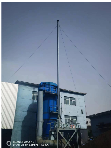
1#除尘器（含风机）排气筒（DA024）
